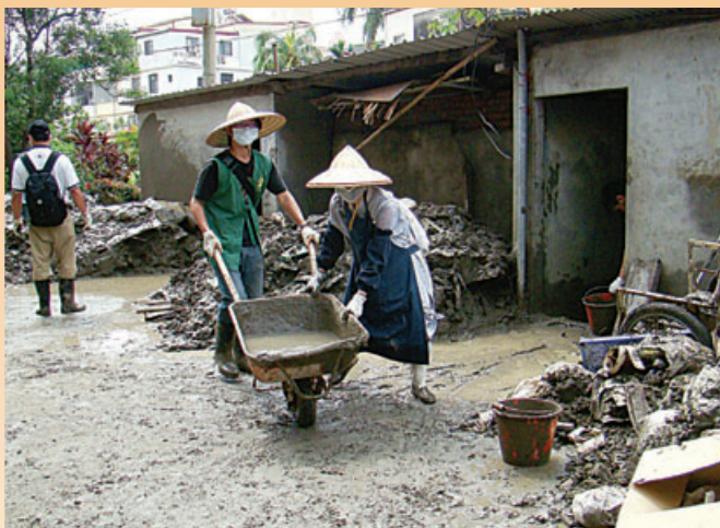
土石流和洪水造成高雄縣旗山鎮社區民宅滿地的泥濘、髒亂，僧團法師與義工們捲起袖子協助清理家園。
